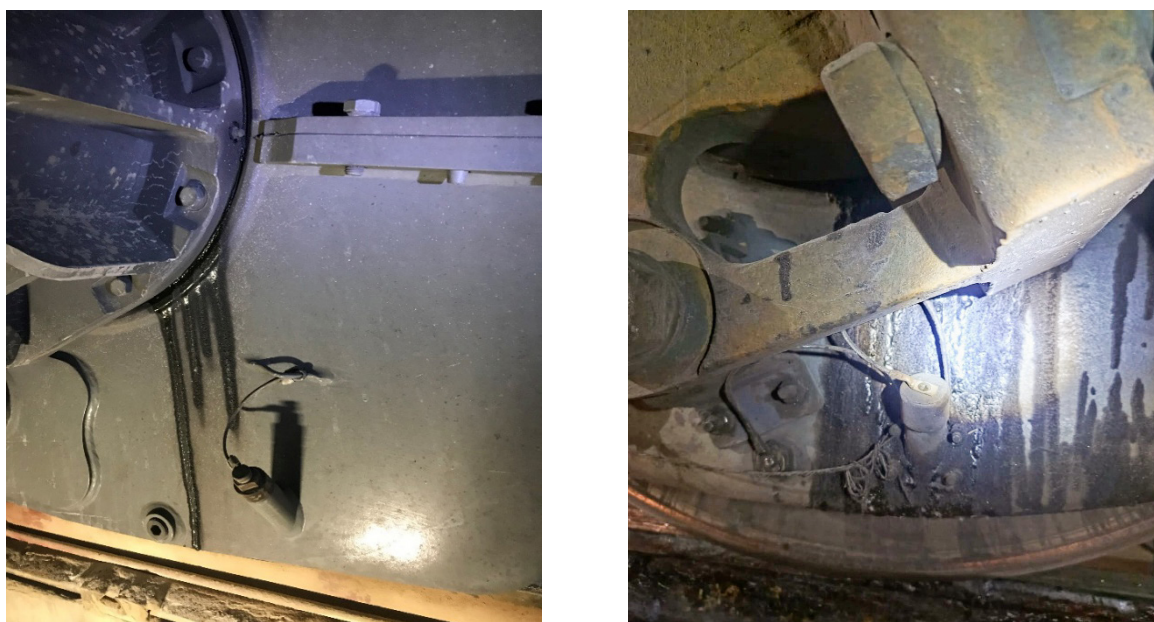
Рис. 5. Состояние существующей конструкции КЗП после 30 тыс. км пробега локомотива (фото Д. А. Колотай)
