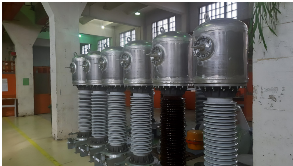
Рис. 1. Трансформатор высоковольтный ТГФМ-110. Фото С. В. Николаева
