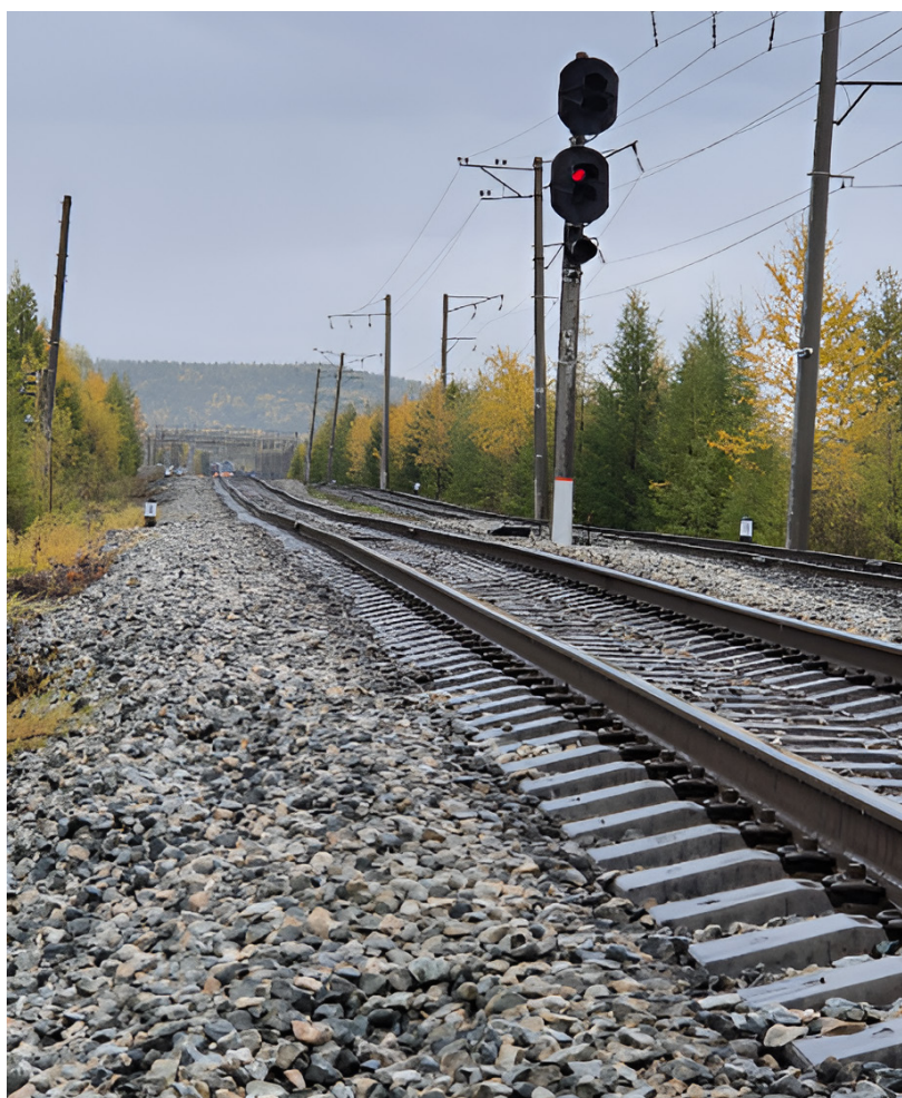
Рис. 4. Деформация земляного полотна (просадка). Фото А. В. Святогоровой
