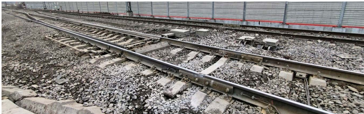
Рис. 5. Просадка железнодорожного пути в зоне рельсового стыка (фото автора)
