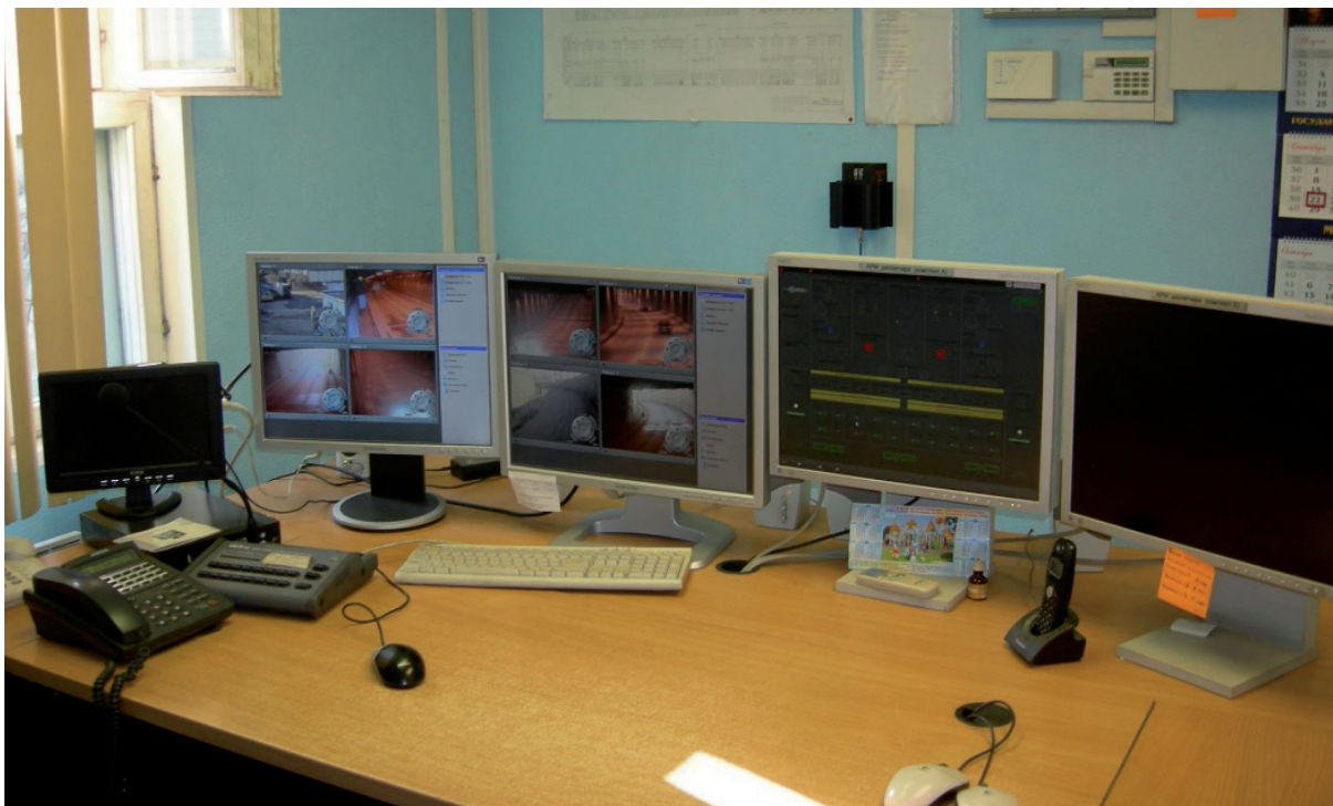
Рис. 5. Система видеонаблюдения и охраны в Канонерском транспортном тоннеле
