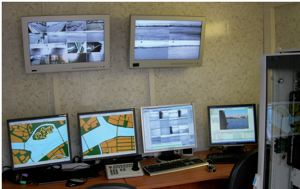
Рис. 2. Система радиолокационного контроля, охраны и видеонаблюдения на Троицком мосту
