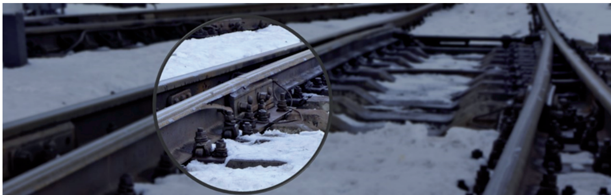
Рис. 1. Износ рельсовой колеи на сортировочной горке
